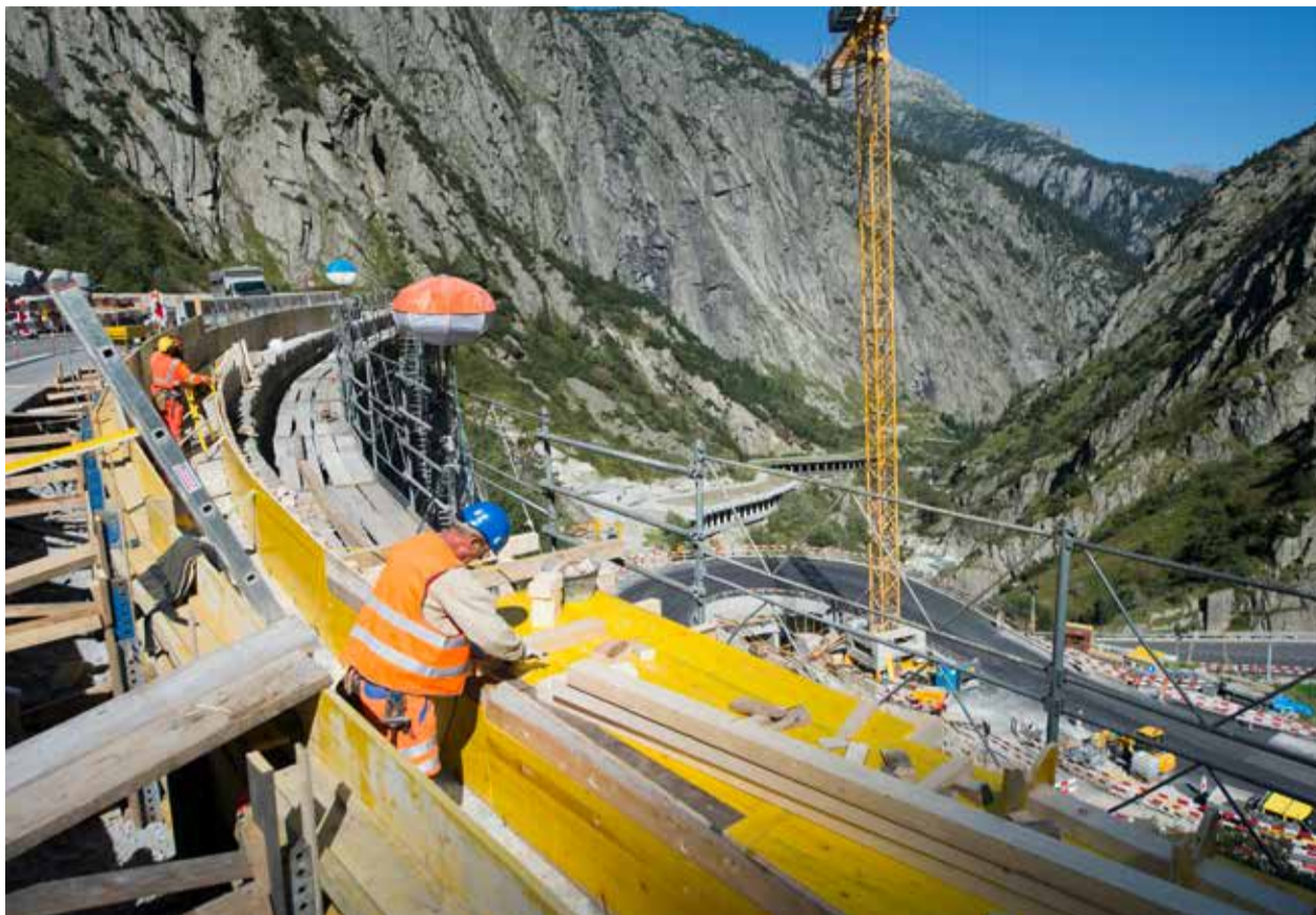
Die Bauarbeiten an der Gotthardpassstrasse A2 in der Schöllenenenschlucht zwischen Göschenen und Andermatt gehen zügig voran. Andersorts verzögert sich der Ausbau des Nationalstrassennetzes. Bild Key
